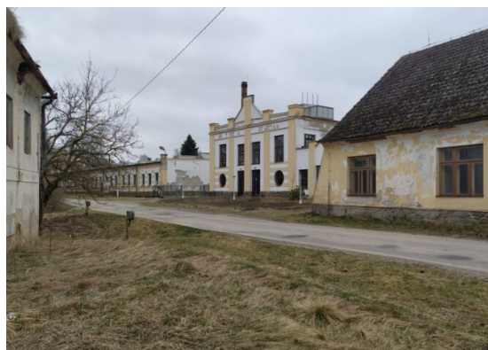
Chátrající budovy firmy Skloform a.s.
